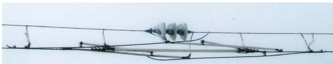
図6 交流20kV 在来線用FRP セクション
